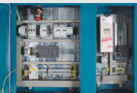
Elektroschaltschrank mit Frequenzumrichter
